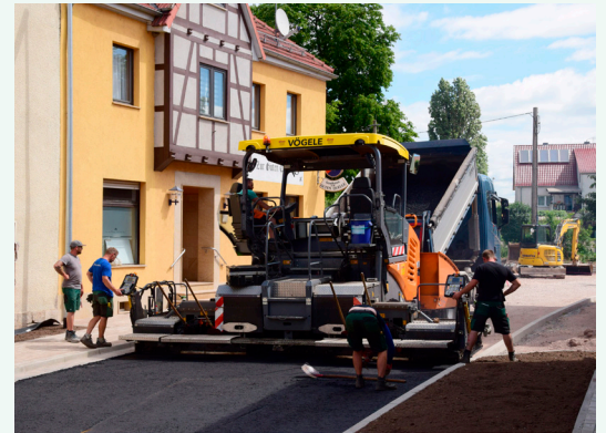
▲ Ein großer Tag für das Bauvorhaben und die Anwohner: Am 1. Juli 2020 wurde die Schwarzdecke beim Abschnitt Kastanienstraße-Schrödergasse aufgetragen. In der Storchgasse war dies bereits einige Wochen zuvor geschehen.
